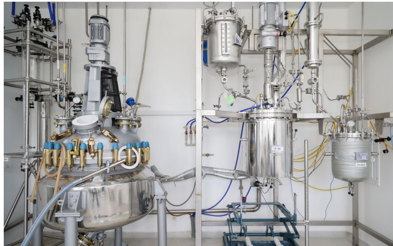
Реакторная зона опытно-производственного участка
